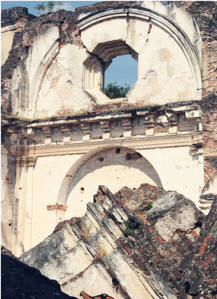
i-18 Muros derruidos y grietas del templo conventual de La Recolección, Antigua, Guatemala
